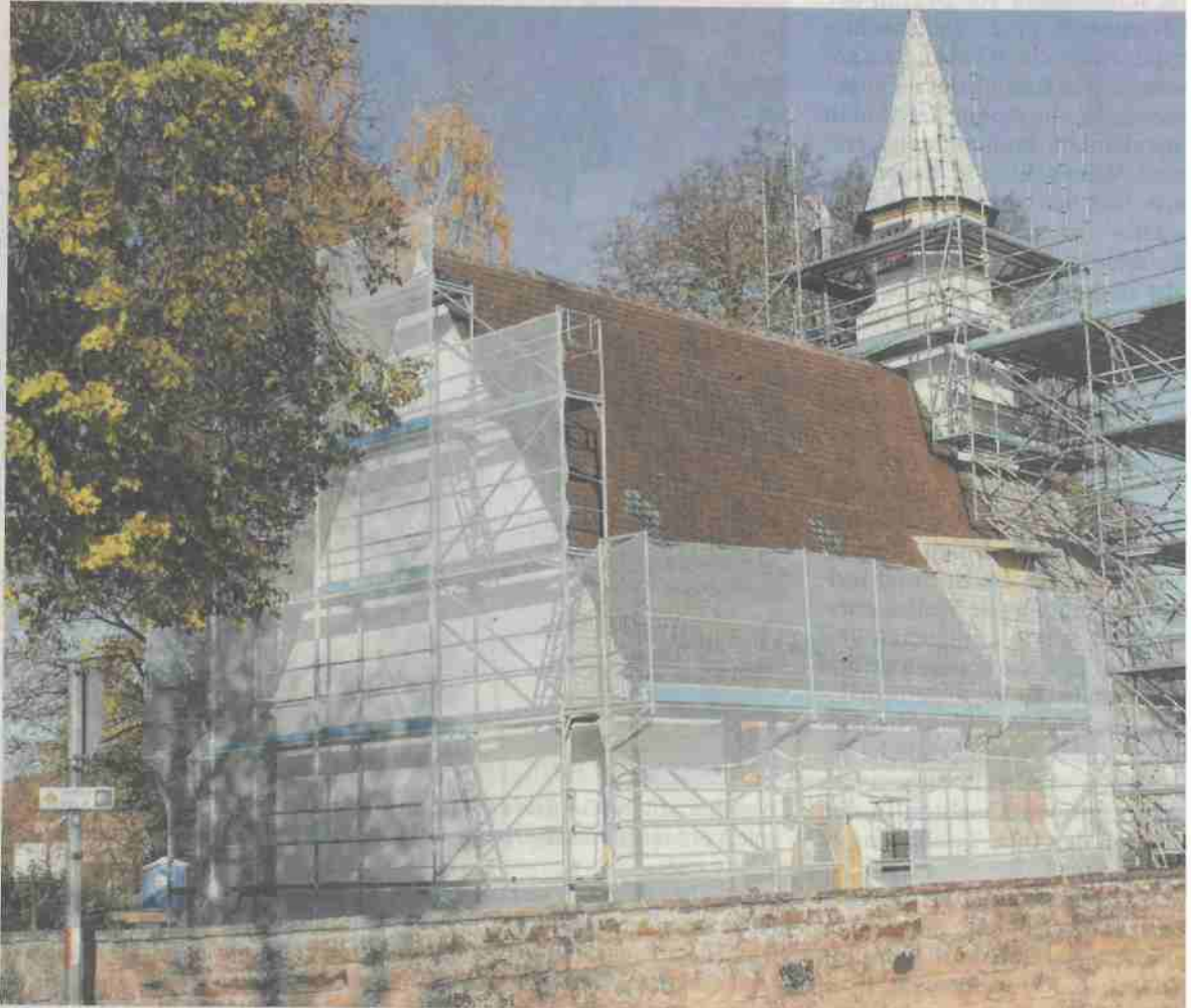
Die Jakobus-Kapelle in Krummwälden wird grundlegend erneuert. Durch Glockenschwingungen sind Risse im Mauerwerk entstanden. Foto: Iris Ruoss
